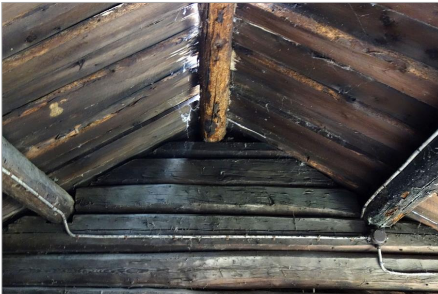
Innertaket är nedsotat efter många år av eldning i pannmuren och ässjan.
